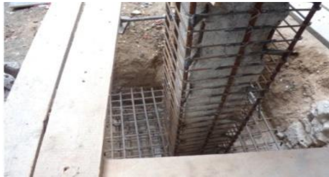
Σχήμα 9. Κλωβός οπλισμού σε υφιστάμενο υποστύλωμα για επίτευξη περίσφιξης με μανδύα οπλισμένου σκυροδέματος (το σκυρόδεμα θα είναι εκτοξευόμενο).
