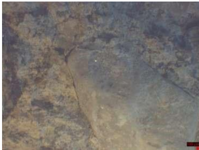
Σχήμα 8. Μικροσκοπική παρατήρηση σκυροδέματος (γέφυρα Στρυμόνα)
