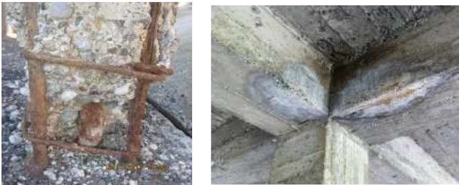
Σχήμα 3. Ολική αποκόλληση σκυροδέματος, εμφάνιση και διάβρωση οπλισμού σε υποστύλωμα (αριστερά) και εξανθήσεις σε δοκούς (δεξιά) – γέφυρα Βενέτικου
